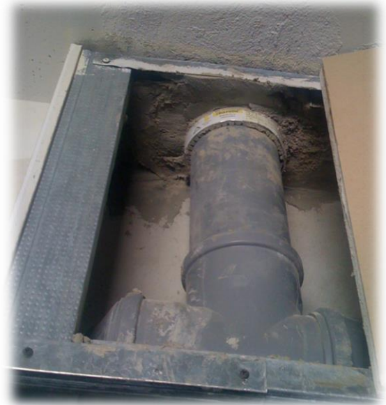
fot. 2 Przepust rury kanalizacyjnej w stropie oddzielenia przeciwpożarowego - tu zabezpieczony
